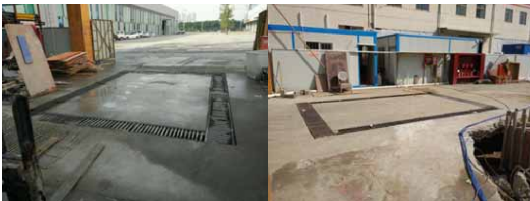
图 4-1 出入口洗车池
